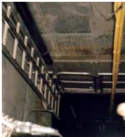
Bild 8: Steigleiter mit Seitenholmen, Steigschutzeinrichtung und Podest
